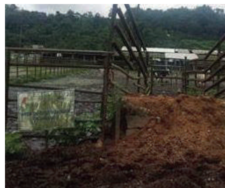
Imagen 10.- Rampa de desembarque en pésimas condiciones.
