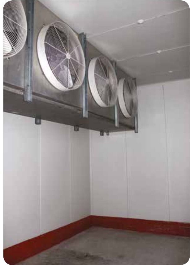
Cuartos fríos sin condensación.
