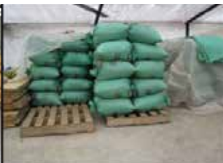
Almacenamiento sobre pallets (foto Ing. Wilson Montoya)
