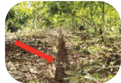
Canal de drenaje para evacuar excesos de agua (foto Intercalidad)
