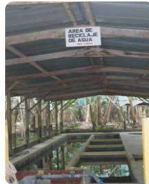
Area de reciclaje de agua.
