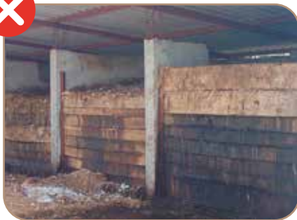
Compostera con presencia de lixiviados
