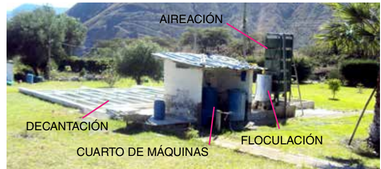
Planta para tratamiento de agua en granja
