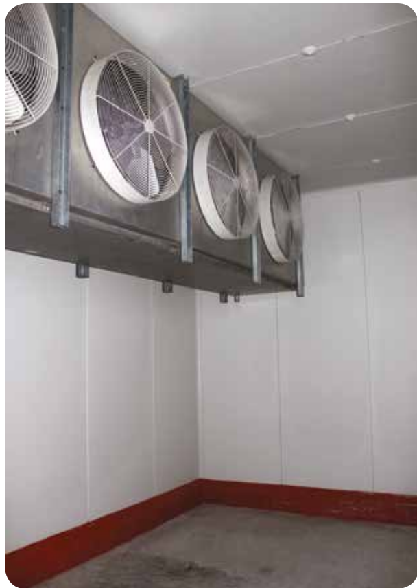
Cuartos fríos sin condensación.
