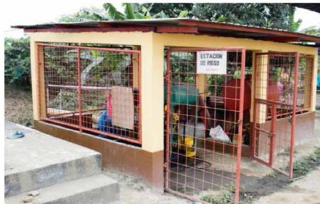
Sistema de bombeo.
