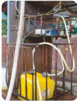
Tanque y bomba para aplicación de cloro al agua que va a ser reciclada en la tina de proceso.
