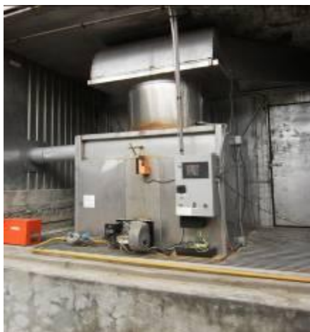
Figura 8. Equipo generador o fuente de calor
